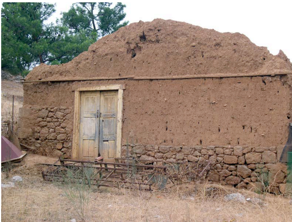
Fig. 7: Costruzione rurale con basamento in pietrame e muri in argilla e legno
